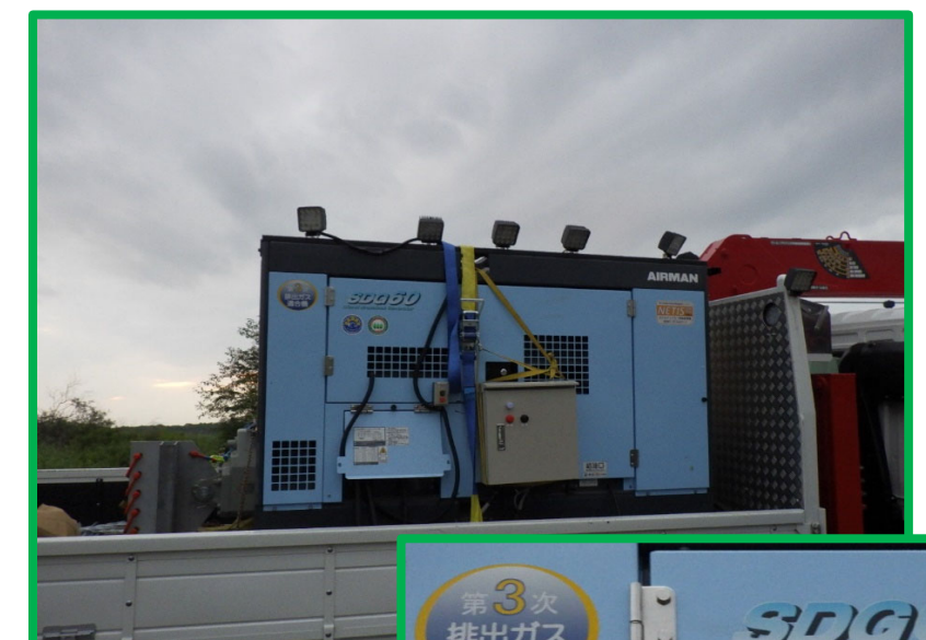
60KVA発動発電機(パワーシリンダー稼働用)
