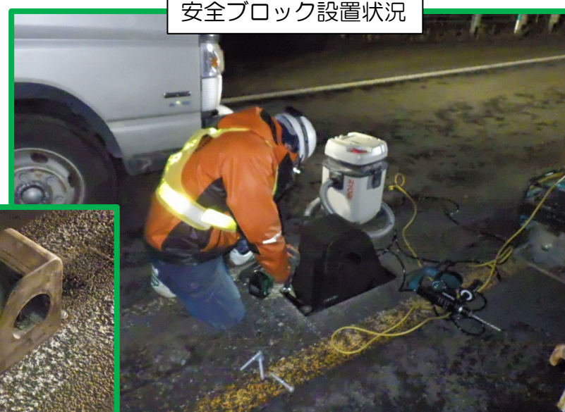
安全ブロック設置状況
